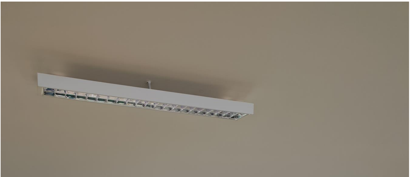
Fig. 11 - Dettagli del sistema di illuminazione delle aule
