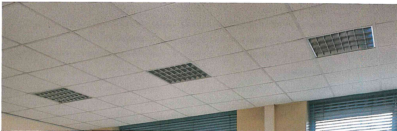
Fig. 8 - Dettagli del sistema di illuminazione della aule
