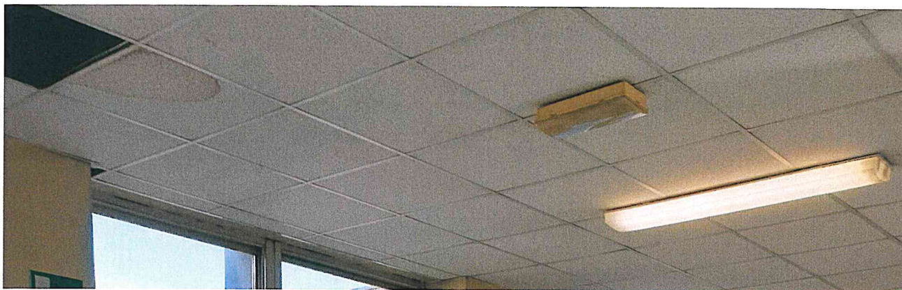
Fig. 9 - Dettagli del sistema di illuminazione dei corridoi e del sistema di illuminazione d'emergenza
